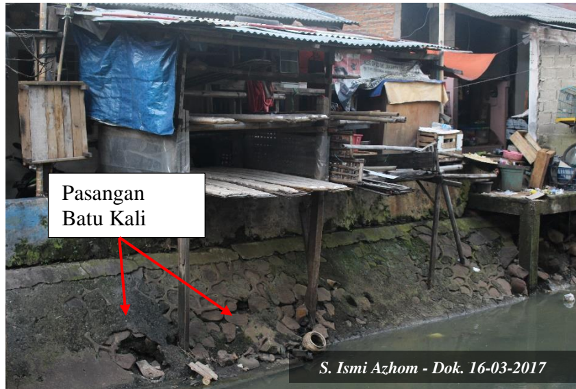
Gambar 10 Kondisi fisik dinding saluran drainase sekunder
