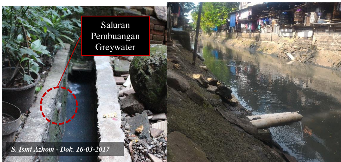
Gambar 8 Foto Penyaluran Greywater di Permukiman RW 07 Kelurahan Tebet Barat Tahun 2017
